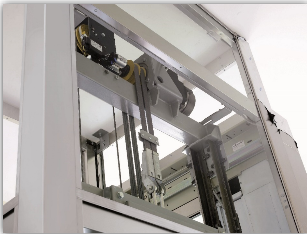
Рис. 5. Электропривод лифтового оборудования
