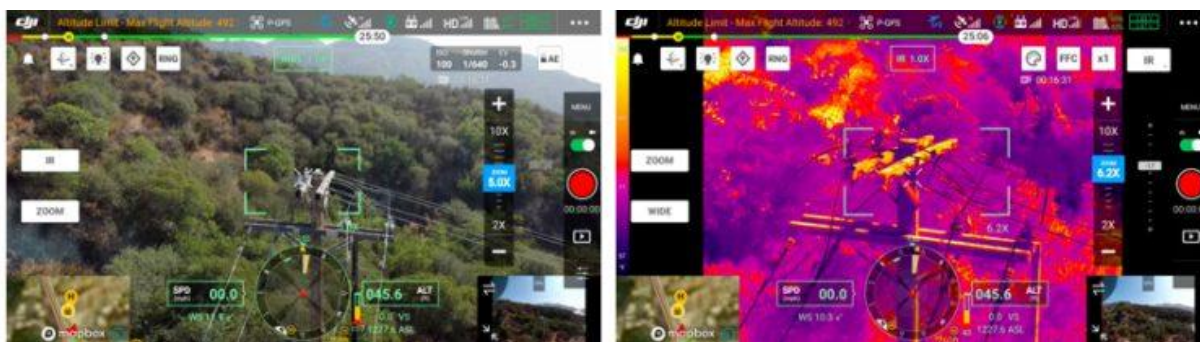
Рисунок 1. Тепловой снимок опоры ЛЭП
