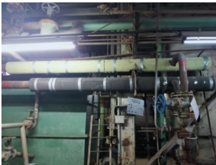
Рисунок 1. Теплоизоляция на трубопроводах
