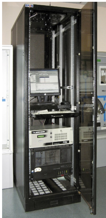
Рисунок 2. Стойка с оборудованием центра сбора и обработки данных.
