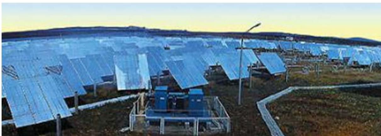
Рисунок 1.10 – Крымская солнечная электростанция термoeлектрического типа
