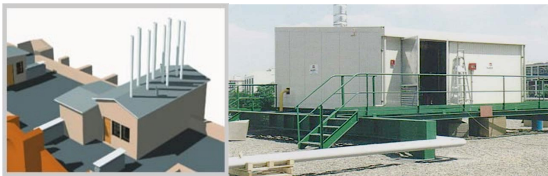
Рис. 12. Внешний вид крышной котельной
