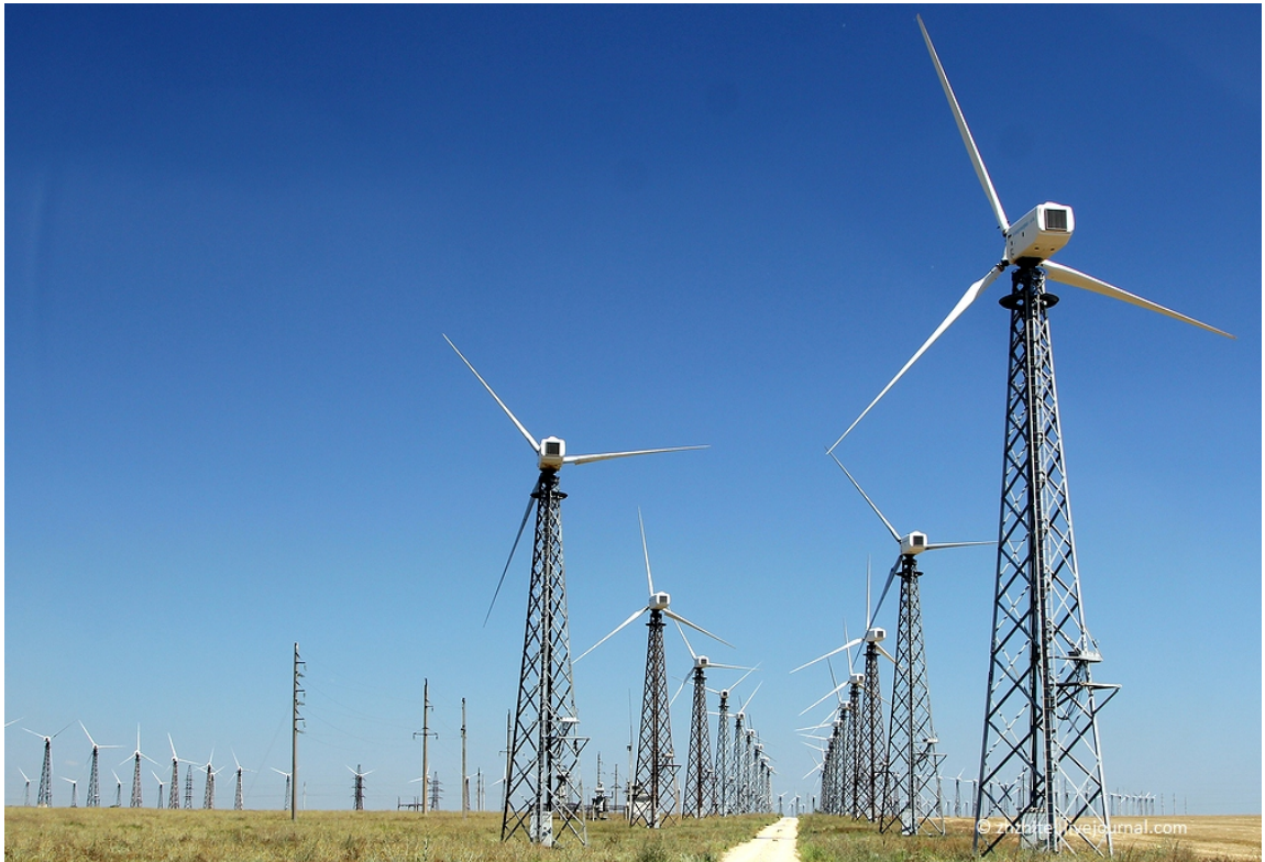
Рис. 1.17. Мирновская ВЭС расположена в западной части Крыма недалеко от пос. Мирный; здесь установлены 155 ВЭУ общей мощностью 18,46 МВт
