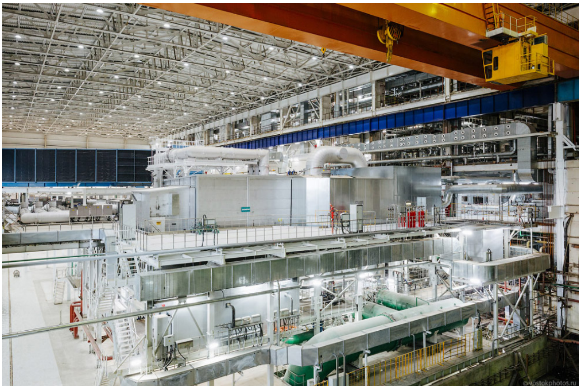
Рис. 3.45. Новый парогазовый (ПГУ) энергоблок Пермской ГРЭС
