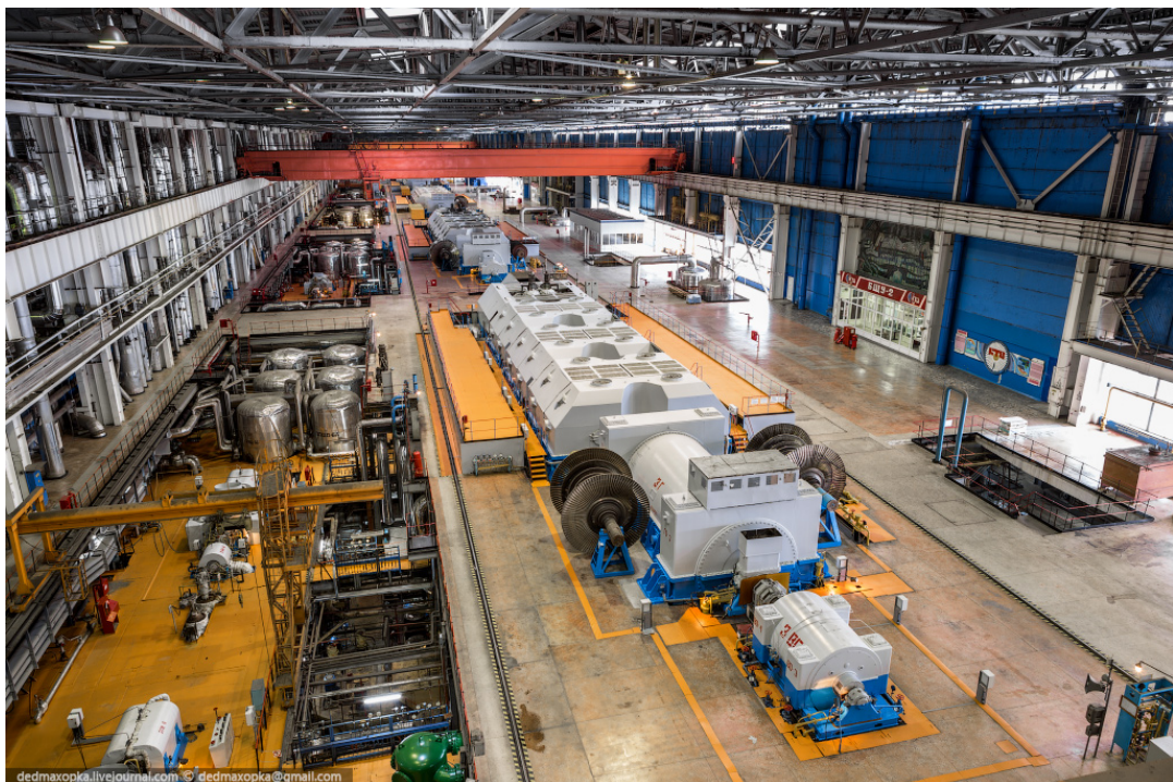
Рис. 1.3. Сургутская ГРЭС-2. Машинный зал, где расположены 6 паровых турбин К-800-240-5
