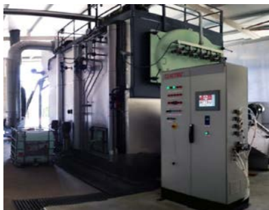
Рисунок 4. Шкаф управления промышленным котлом с ПЛК сенсорной панелью оператора
