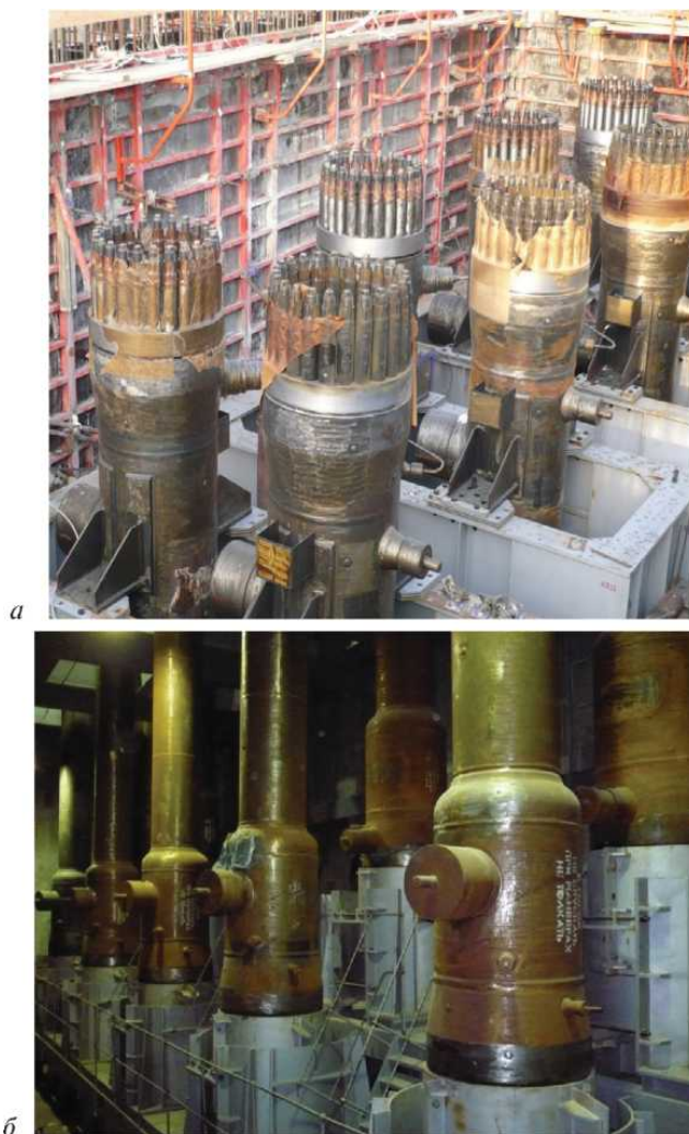
Рис. 4.28. Вид парогенератора Н-272 на верхней (а) и нижней (б) опорах модулей
