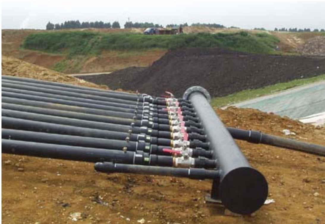
Рис. 14.3. Трубопроводы для сбора свалочного газа
