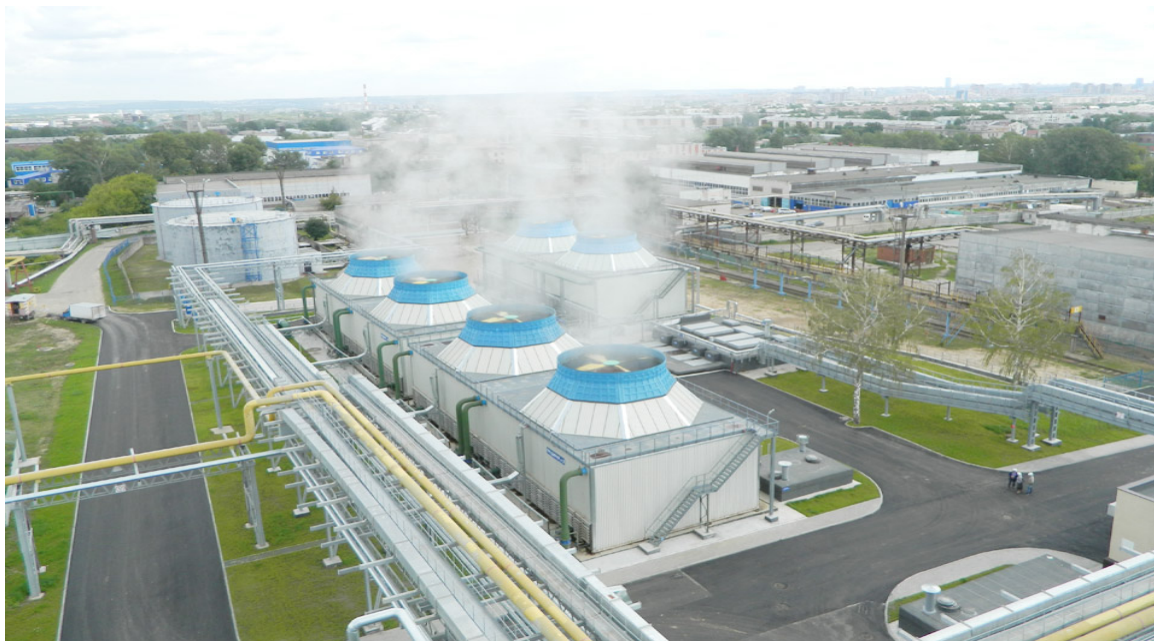
Рисунок 10.2 – Секционные градирни ТЭС
