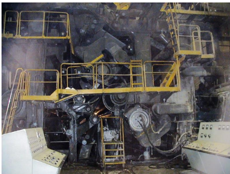
Рис. 6.3. Прессовая часть БДМ с лицевой стороны.
