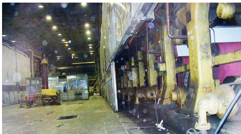
Рис. 6.4. Сушильная часть БДМ с лицевой стороны.
