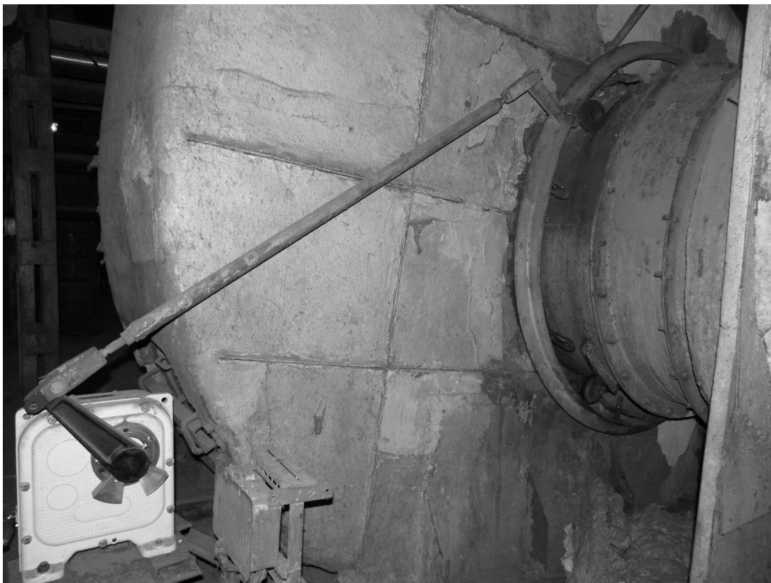
Рис. 10. Исполнительный механизм МЭО, соединенный с направляющим аппаратом вентилятора парового котла
