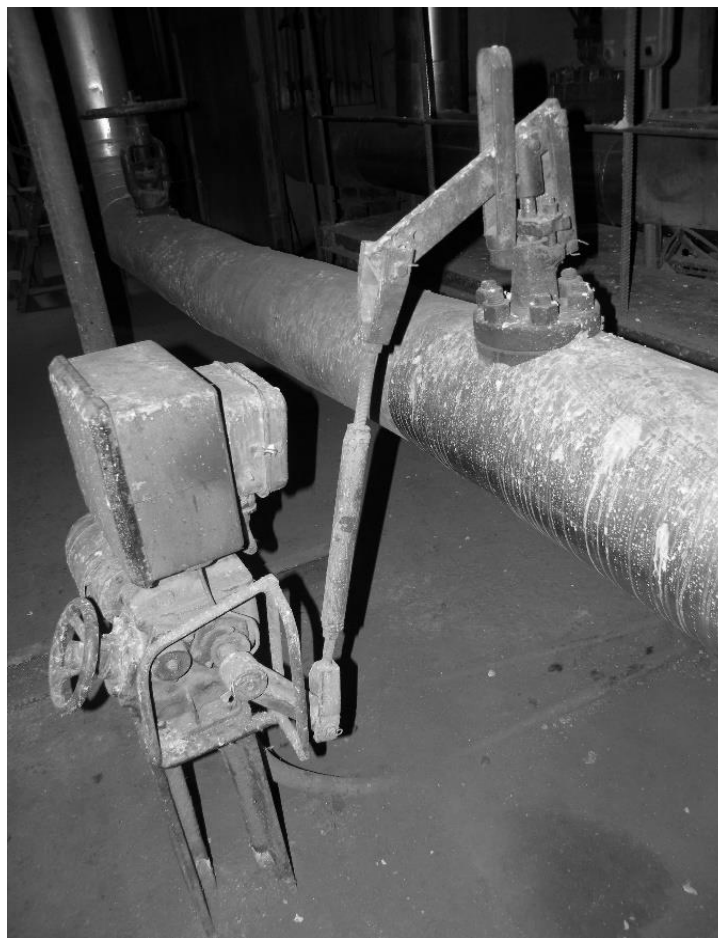
Рис. 9. Исполнительный механизм МЭО, соединенный с регулирующим клапаном на питательном трубопроводе Ду 100 парового котла
