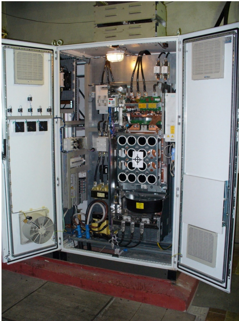
Рис. 4.3. Шкаф с преобразователем частоты 160 кВт
