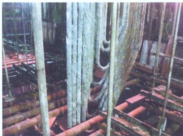
Рис. 5. Вид трубного пучка СРК 1500 с высоким солевым наростообразованием после длительной эксплуатации [8]
